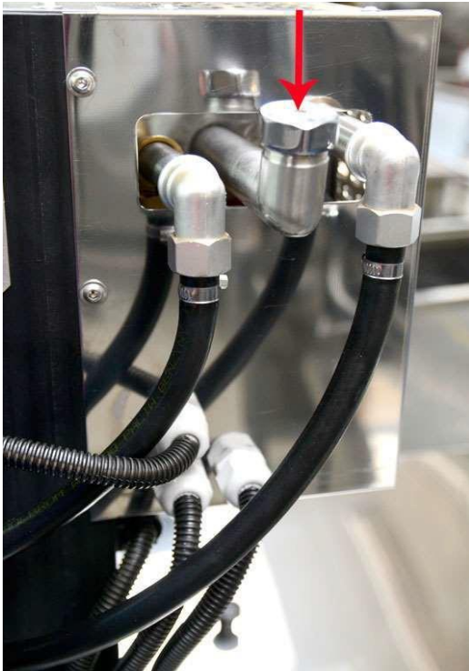
Fig. 22 fill up port.
